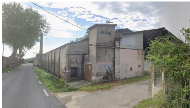
Une partie du bâti dégradé en bordure de RD980, en attente de rénovation.
